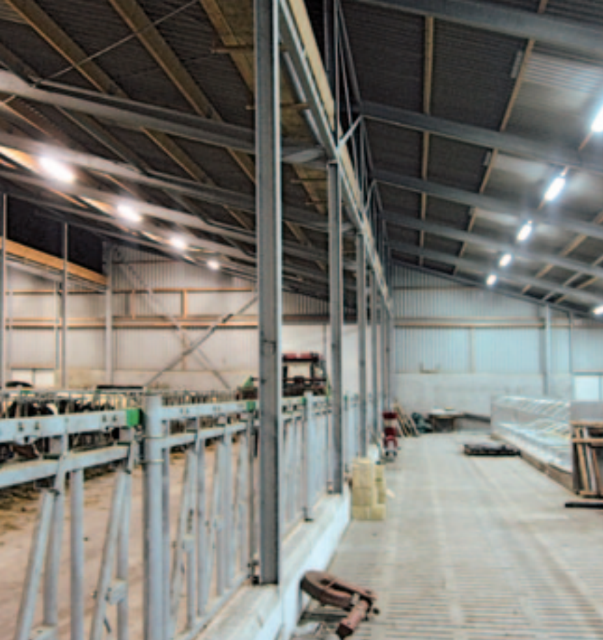
Het zichtbare verschil tussen led en tl. Links tl-balken, rechts ledbuizen. Wat lichtopbrengst betreft is er geen onderscheid.
